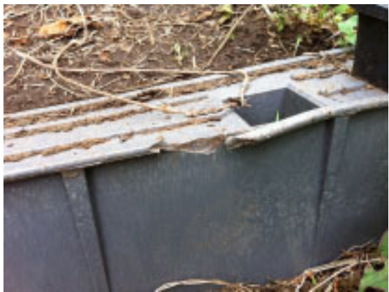
188番から187番の間に見られた破損。 同じ場所の破損。
