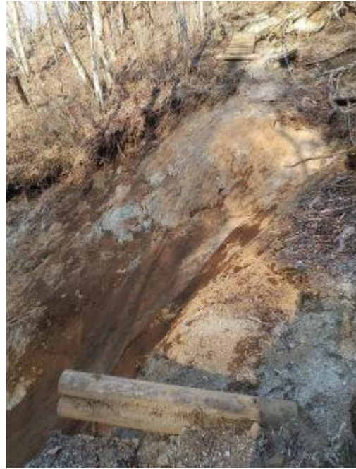
崩落現場②
