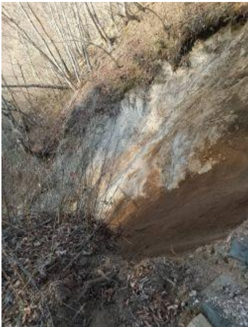
崩落現場③
